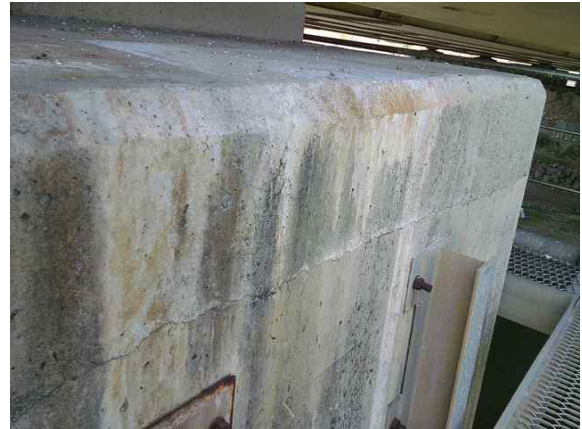
P8 코핑부 균열(폭 0.2mm)
